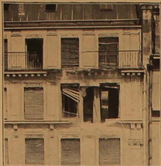
4, rue de Berne : les fenêtres éventrées par un fragment du foyer.
